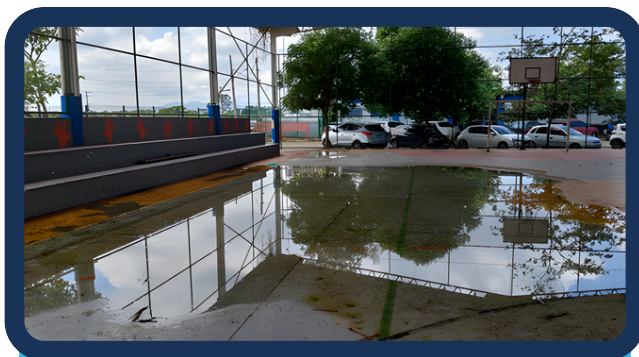
Foto de unidade escolar com piso comprometido, apresentando desníveis, fissuras e pontos de alagamento.
